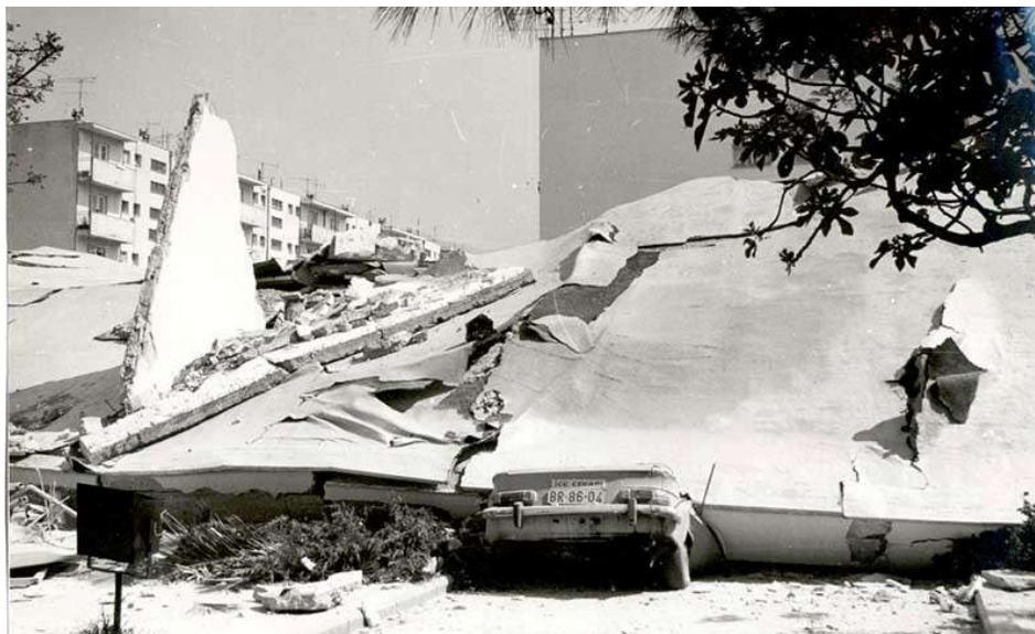
Slika 15. Srušena zgrada Suda u Baru, 15. Aprila 1979.
